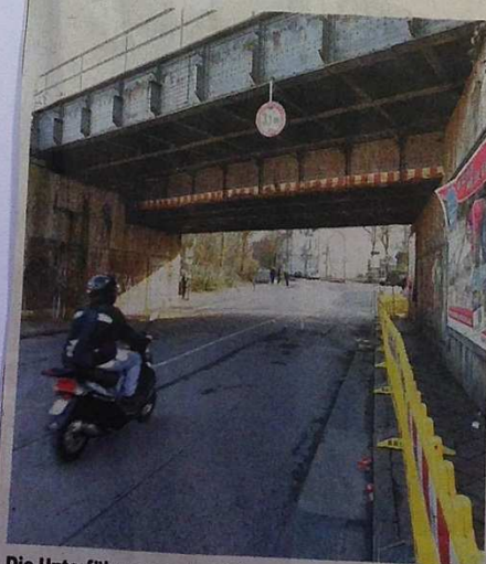
Die Unterführung an der Küppersbuschstraße wirkt wenig einladend. Sie soll verschönert werden.
